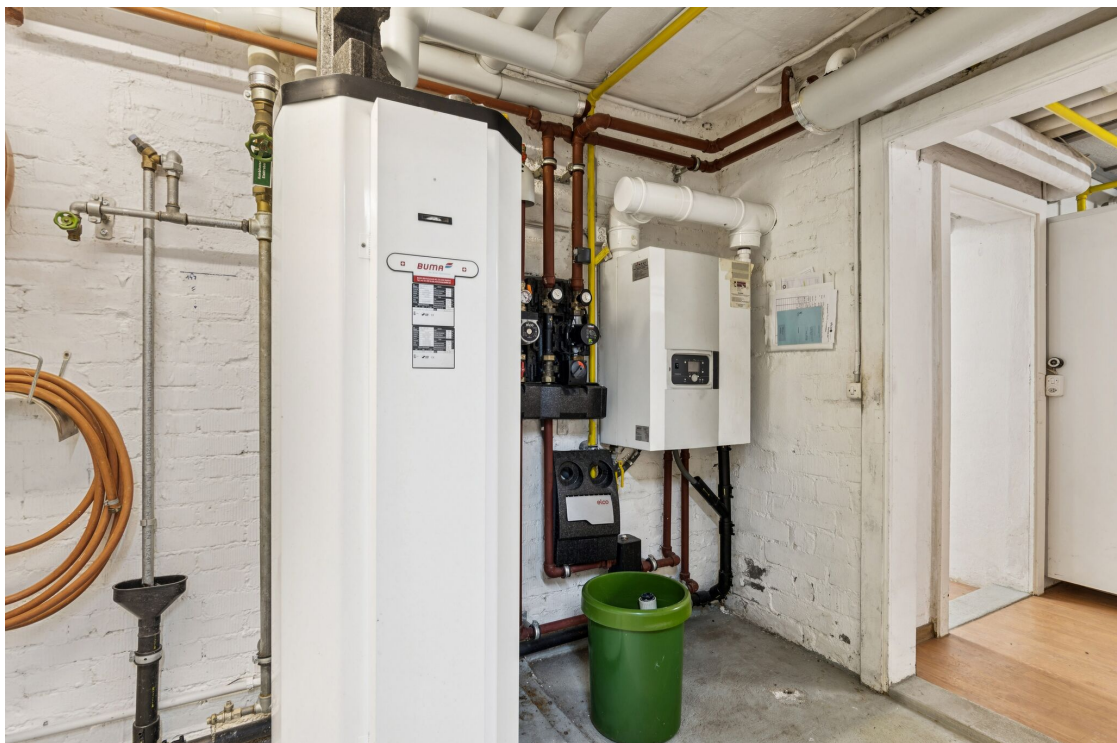
Chauffage à gaz
